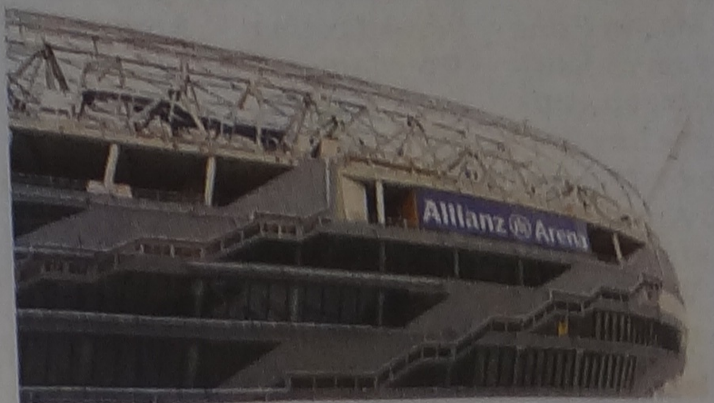
Noch Baustelle, 2006 der (Haupt-)Ort des Geschehens in München: die Allianz-Arena. Foto: Schlüter
